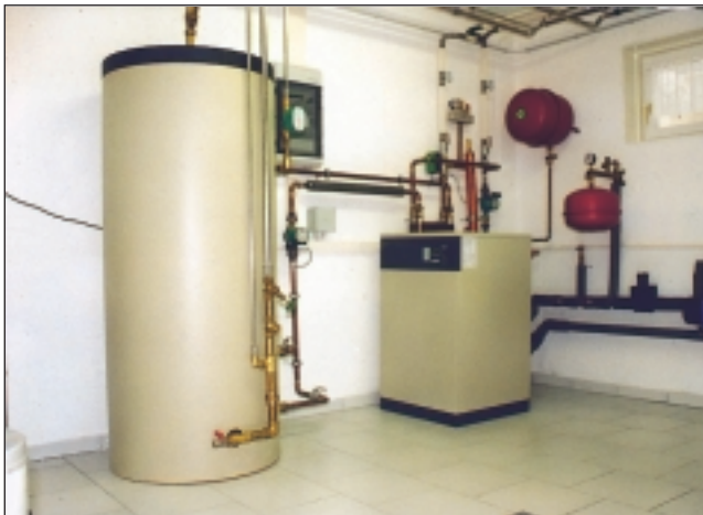
Abb. 9 Heizungskeller mit Wärmepumpe
